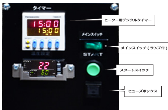
KEYENCE 製の温度設定管理システムを搭載した総合コントロールボックス
